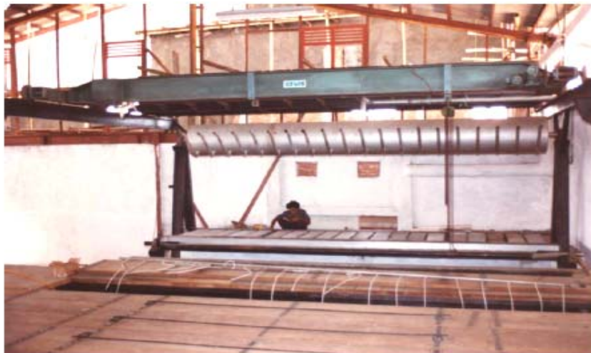
Overhead Gantry Crane dan Ice Can Filler yang dapat mengisi air untuk 20 cetakan es bujur sangkar ukuran 25 kg sekaligus, pada Pabrik es balok dengan kapasitas 50 metric tons /24 jam di Pekalongan, Jawa Tengah.
